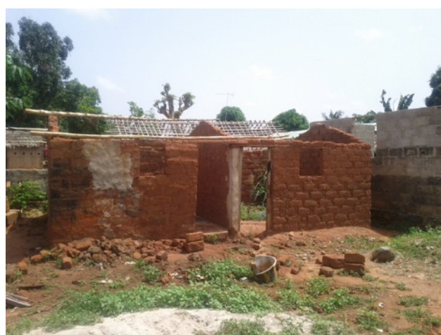
Maison en terre endommagées et abandonnées, Carrefour, Doukoue
