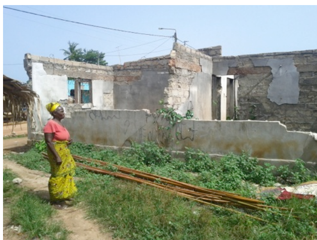
Maison en dur endommagées et abandonnées, Carrefour, Doukoue
