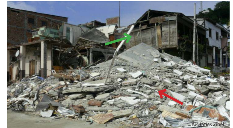
Vivienda tradicional en pie al lado de inmueble colapsado de bloques de cemento (Bahía de Caráquez) ©Matias Zibell
