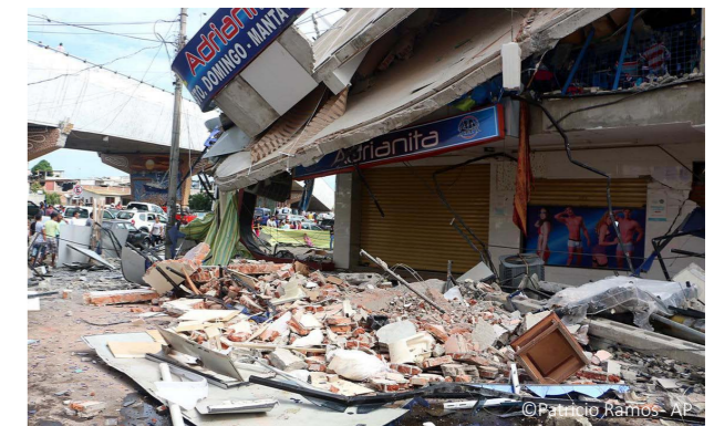
Inmueble colapsado tras terremoto en Manta
