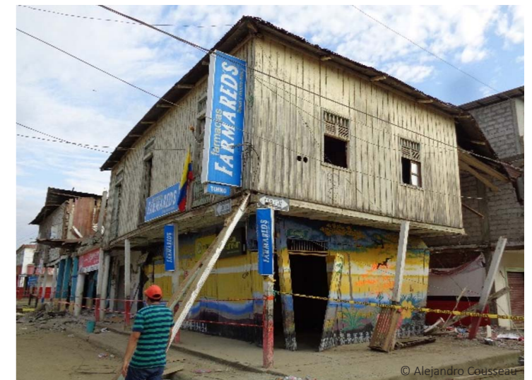
Vivienda urbana tradicional de madera en el municipio de Jama, dañada tras terremoto pero no habiendo colapsado ©Alejandro Cousseau
