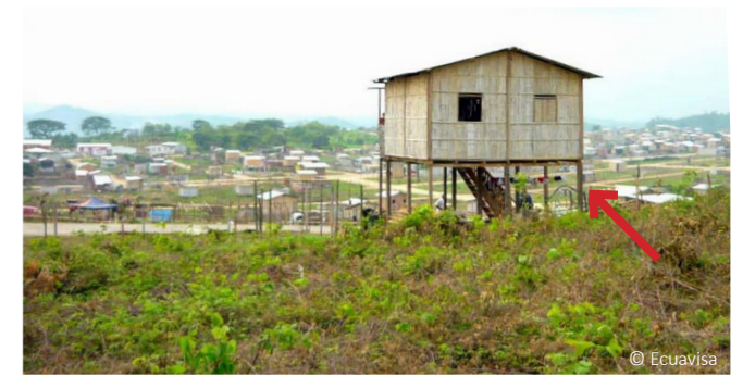
Ausencia de arriostramientos en la planta baja
